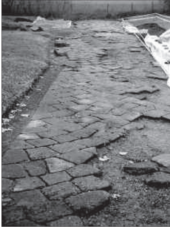
Fig. 4. Lastricato in pietra della via Claudia nell'ambito della porta settentrionale di Altinum -Quarto d'Altino.
